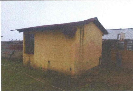
Foto 3: Se observa el deterioro de la cubierta en modulo de cocina
