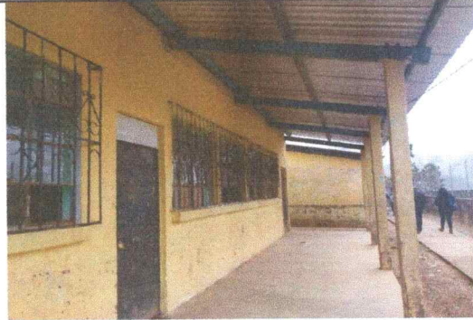
Foto 2 se observa el deterioro de pinturam, falta de piezas de vidrio en ventaneria
