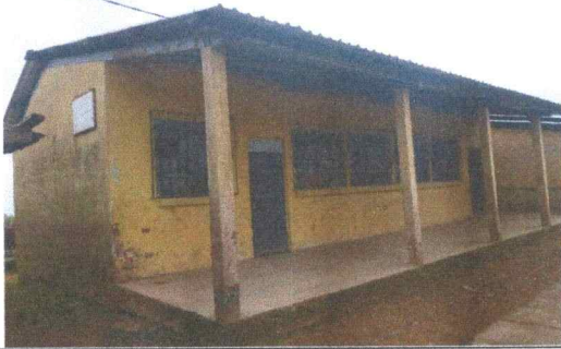
Foto 1: Se observa estructura portante en mal estado
